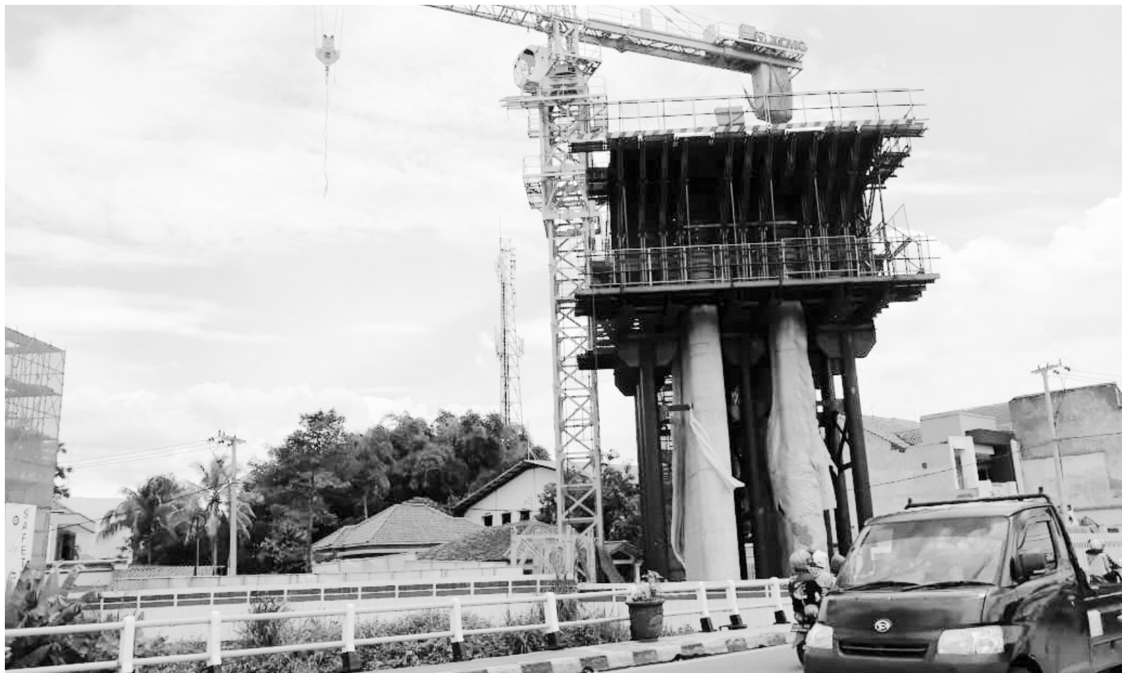
BERDAMPAK BURUK: Proyek Kereta Cepat Jakarta Bandung (KCJB) diberhentikan sementara terhitung mulai Senin (2/3) hari ini, lantaran diduga menyebabkan dampak buruk terhadap lingkungan sekitar.
