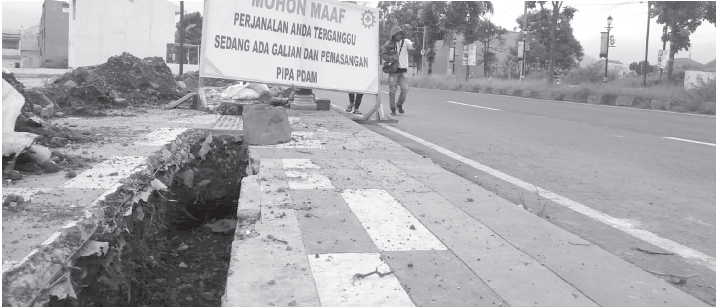
DIBONGKAR: Tak jauh dari kompleks Pemkab Bandung, trotoar Jalan Raya Soreang dan Jalan Terusan Al Fathu terlihat semerawut karena adanya galian proyek pemasangan pipa Perumda Air Minum Tirta Rahaja.
