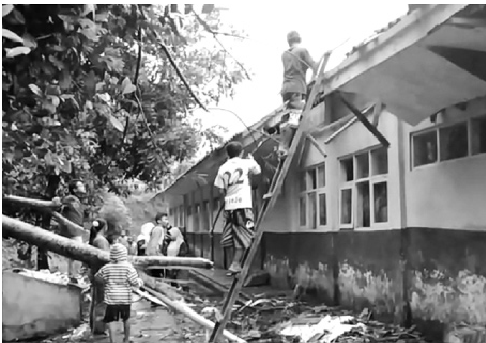
TIMPA: Hujan dengan intensitas tinggi menyebabkan pohon besar tumbang dan menimpa Sekolah Dasar di Kabupaten Tasikmalaya. Akibatnya dua ruang kelas mengalami rusak berat di bagian atap karena tertimpa pohon tumbang tersebut.
