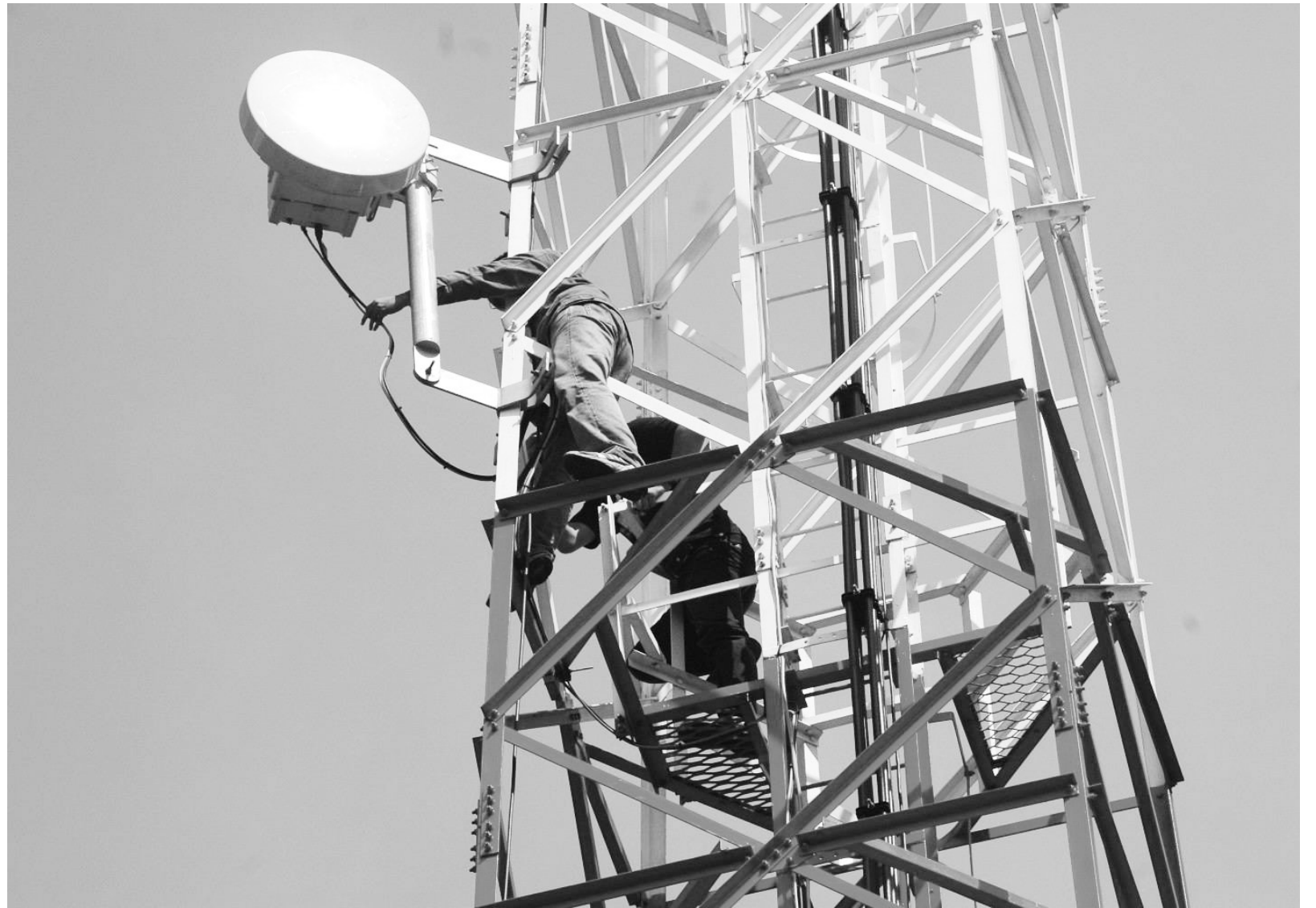
ISTIMEWA PERBAIKI TOWER: Dua orang pekerja terlihat tengah memperbaiki tower seluler untuk memastikan layanan telekomunikasi berjalan dengan baik bagi masyarakat.
