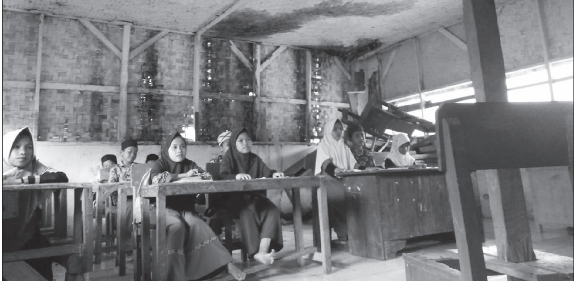
NYARIS RUBUH: Murid MD Awaliyah Nurul Huda, Kampung Mariyuk, Desa Bantar Panjang, Kecamatan Jampangtengah, Kabupaten Sukabumi mengikuti KBM dengan bayang-bayang kecemasan terhadap kondisi bangunan yang sudah lapuk.
