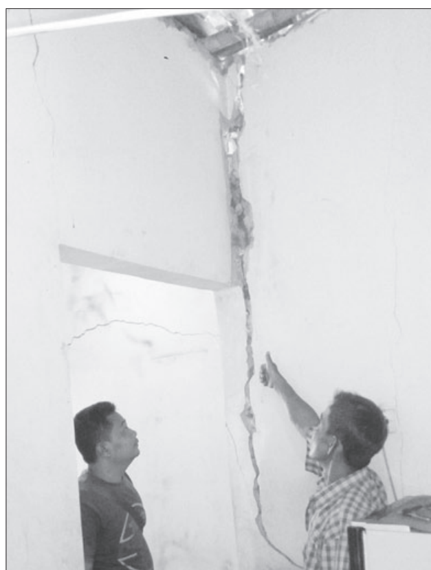
RUMAH RETAK: Sejumlah warga menunjukkan rumahnya yang retak akibat adanya pergerakan tanah, baru-baru ini.
