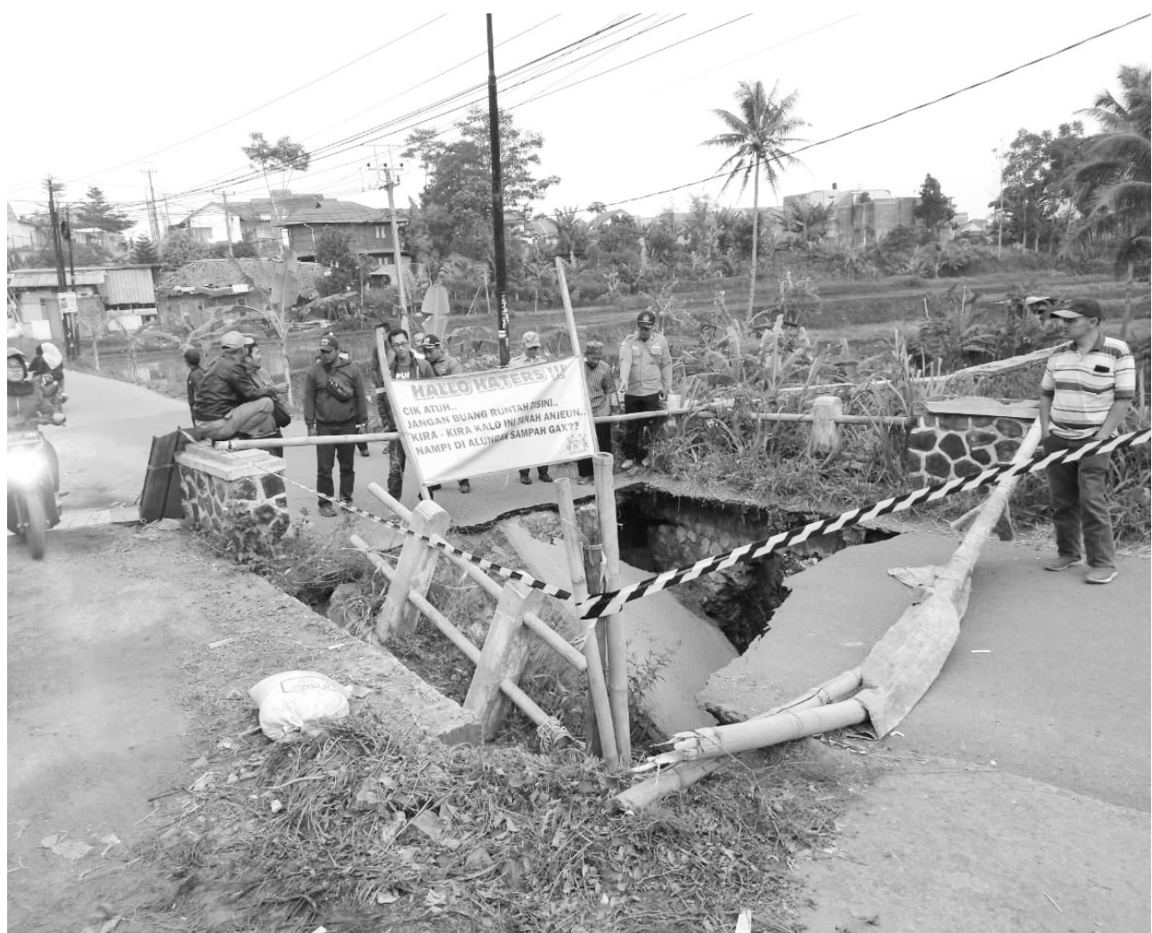
AKSES TERPUTUS: Jembatan Cilengkrang di Desa Cilame, Kecamatan Ngamprah, ambles, Selasa (21/1). Akibatnya akses ke kantor Pemkab terputus.
